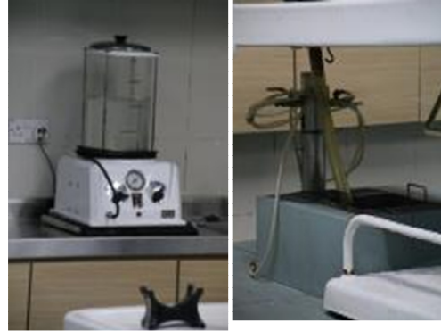
照片 44：防腐藥水灌注幫浦及污水集中系統
