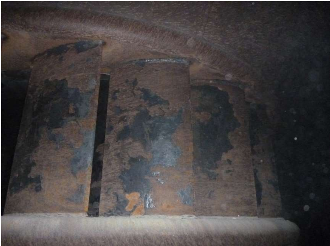
照片 8 三門峽水庫水輪機導翼之磨蝕情況
