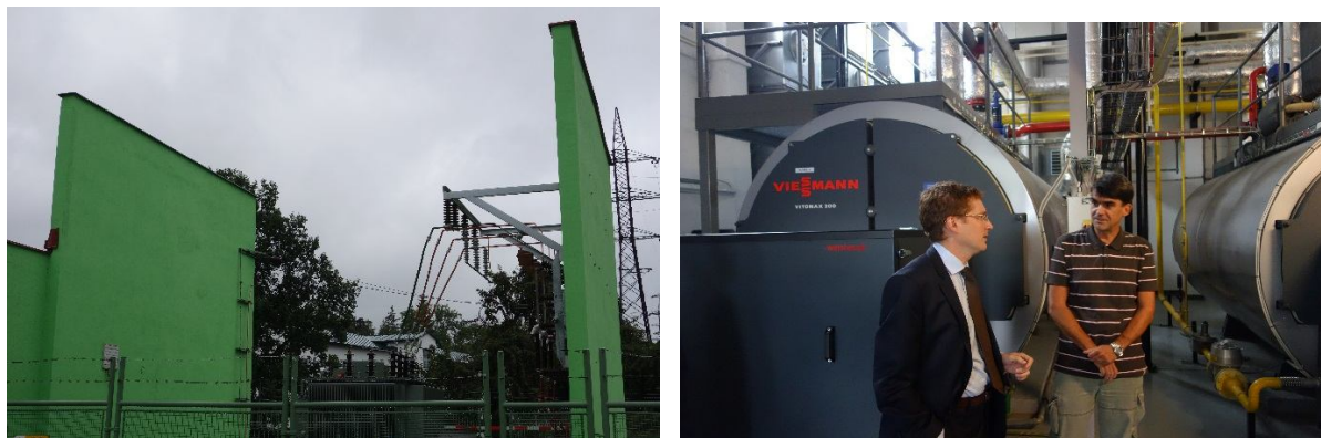
圖 16~17 參觀 Smart Region 示範變電所情景
