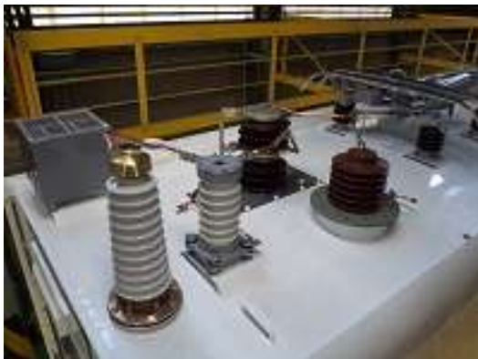
圖 3-101 車頂高壓設備檢查
