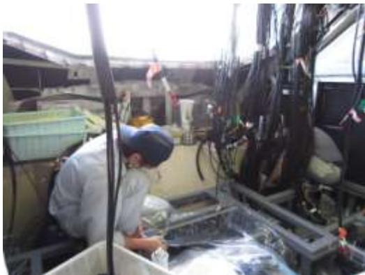
圖 3-71 駕駛室配線檢查
