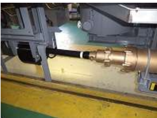
圖 3-97 高壓電纜線檢查
