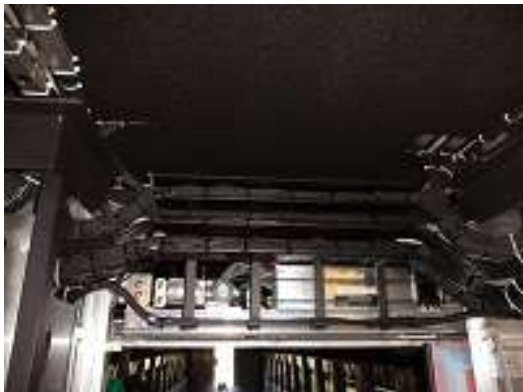
圖 3-69 車內通道門配線檢查
