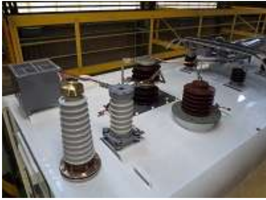
圖 3-83 車頂高壓設備檢查
