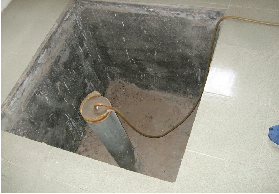
照片三十九、十三陵地震台之地下水流體觀測設備
