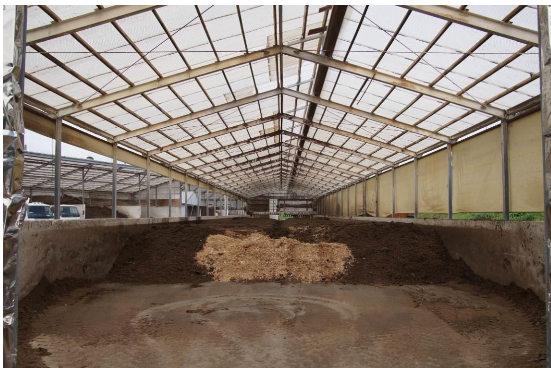
圖 20 和鄉園農業廢棄物回收場最終堆肥翻堆設備。
