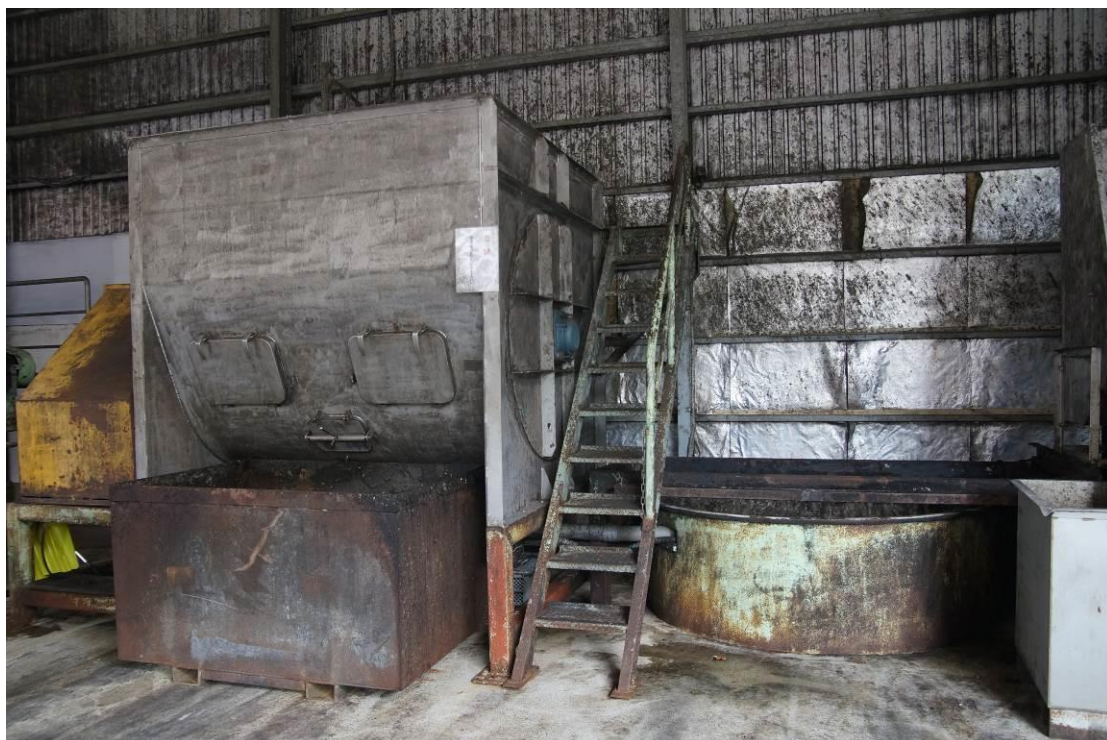
圖 19、和鄉園農業廢棄物回收場脫水設備。
