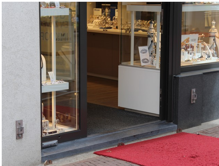
照片 22 每戶門口預留擋水版插槽
