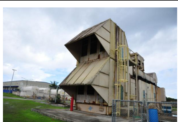
進氣室遮雨棚鋼板銹蝕，需除銹油漆並將鋼板補強
