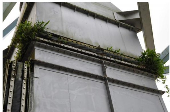
排氣道上之水平及垂直膨脹接頭破損，積水而長出雜草，必須更新
