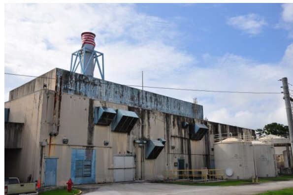
Dededo#1、#2 號機，外牆應重新粉刷，使之煥然一新
