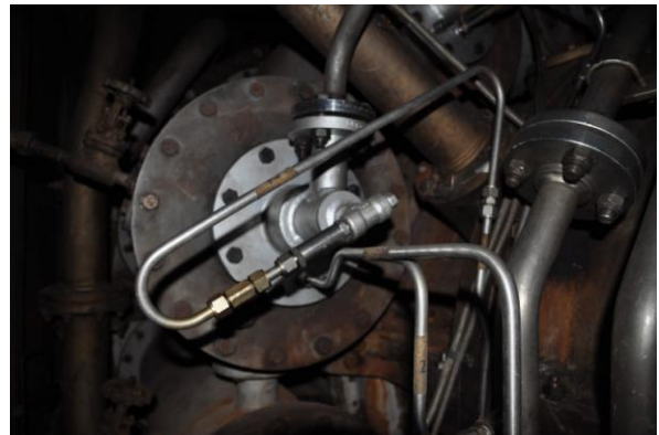
10 只燃燒器需拆解清理
