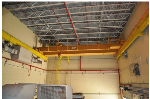
廠房內 20T 固定式起重機，有助日後維修工作
