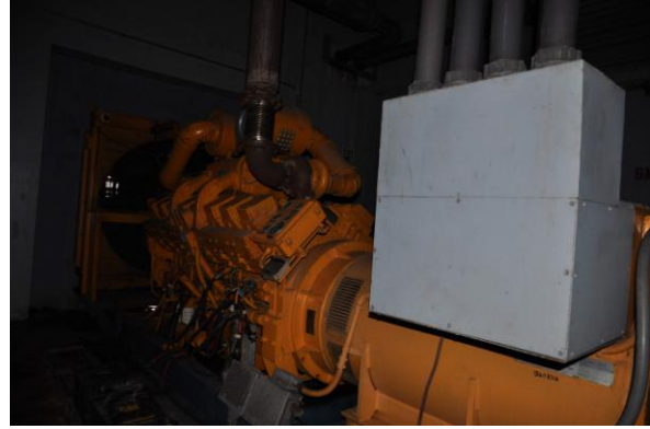
全黑緊急柴油發電機位於 Switchgear 旁，需檢查及試運轉
