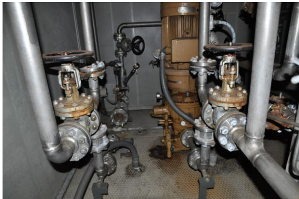
燃料油泵缺一台
