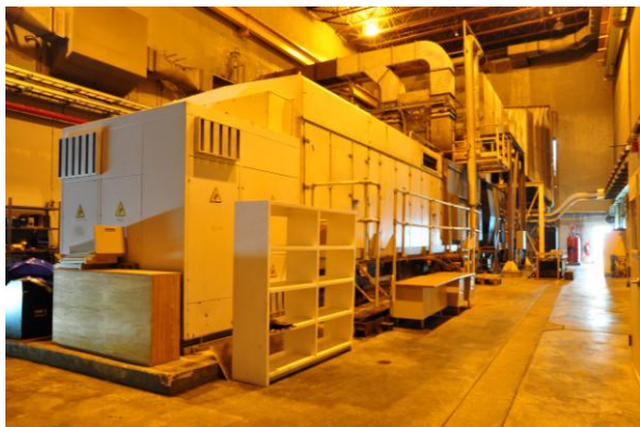
機組安裝於廠房內，外觀良好
