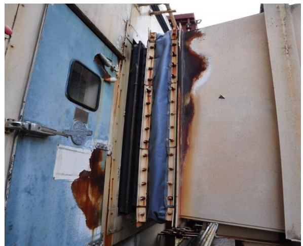
排氣道鋼板亦腐蝕嚴重
