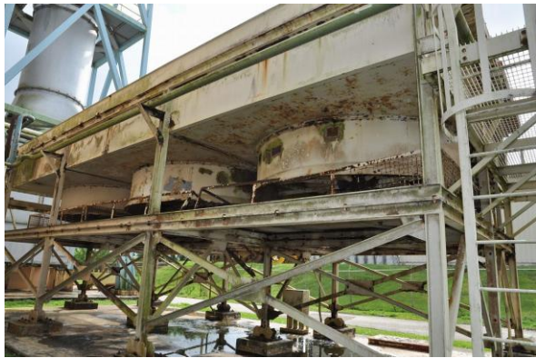
冷卻水塔結構腐蝕嚴重
