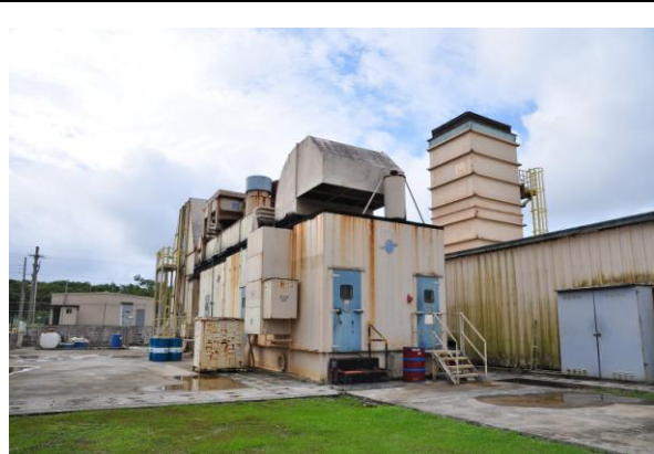
Yigo 為屋外式機組，渦輪機圍體銹蝕斑斑，屋頂情況不明
