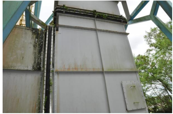
排氣道上之水平及垂直膨脹接頭破損，致使積水而長出雜草，必須更新
