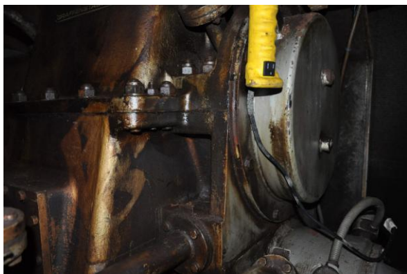
減速齒輪箱漏油，需拆蓋檢查齒輪，清除油垢及更新墊片
