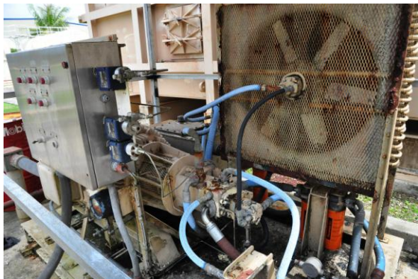
起動用控制油泵生鏽嚴重，外觀十分老舊
