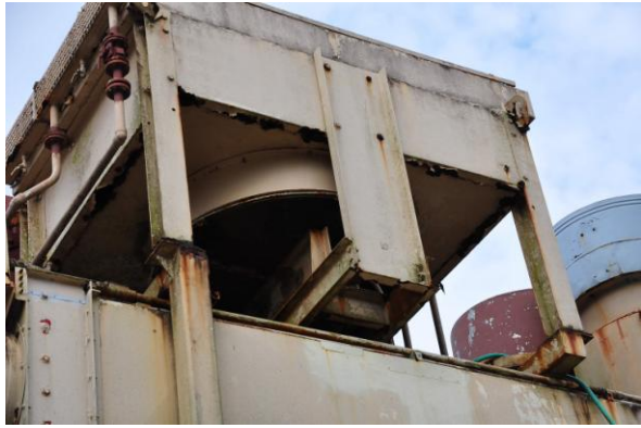
冷卻水塔裝置於渦輪機圍體頂部，鋼構亦腐蝕，且容易使圍體頂部破損漏水
