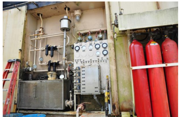
儀控設備屋外式
