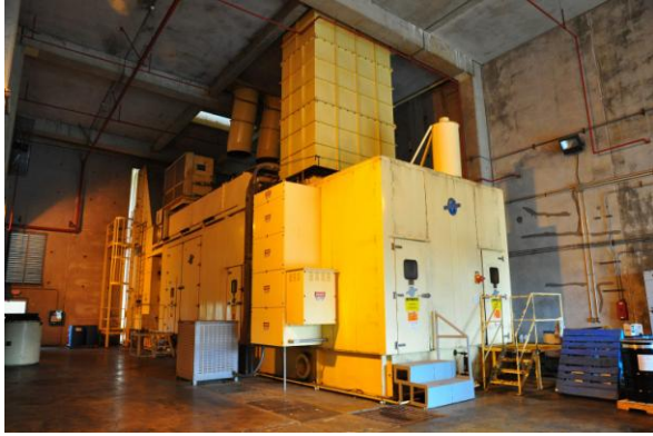
Macheche 電廠為屋內式，但無固定式吊車，目前正常發電運轉中
