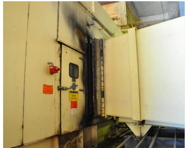
排氣煙道接合面及膨脹接頭漏
