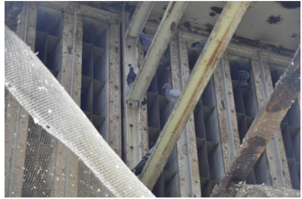
進氣室濾網前已成鳥窩，需徹底清理，過濾網更新
