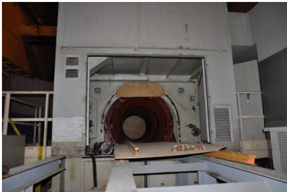
發電機故障，轉子抽出，定子無防塵保護
