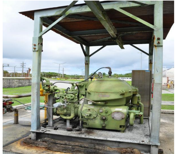
油淨化器滲油，周圍水溝油污甚多
