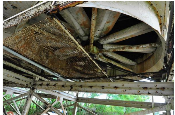
冷卻水塔軸承已不堪使用，需全部更新
