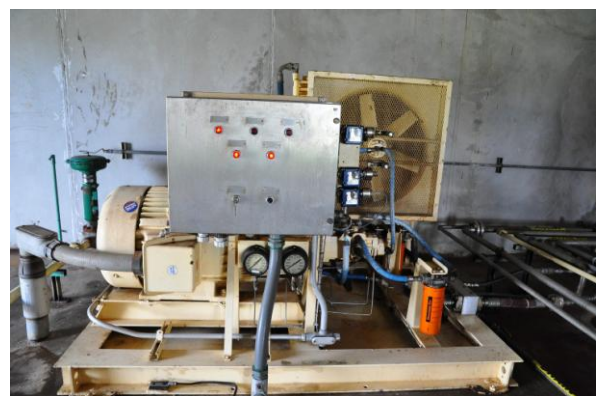
起動用控制油泵外觀整理乾淨
