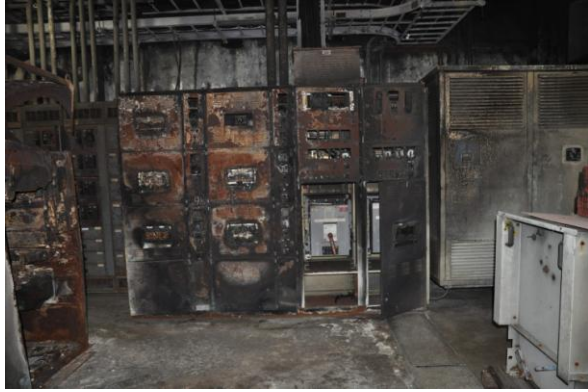
Switchgear 及電纜線因失火燒燬，需整組更新
