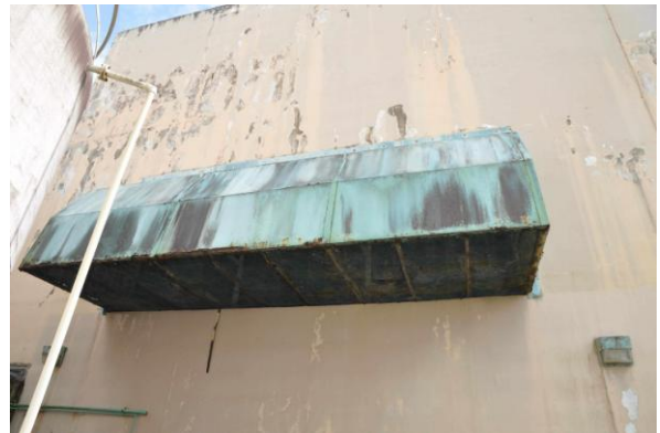
進氣室遮雨棚鋼板腐蝕破孔，防鳥網無破洞，情況比#1 機好
