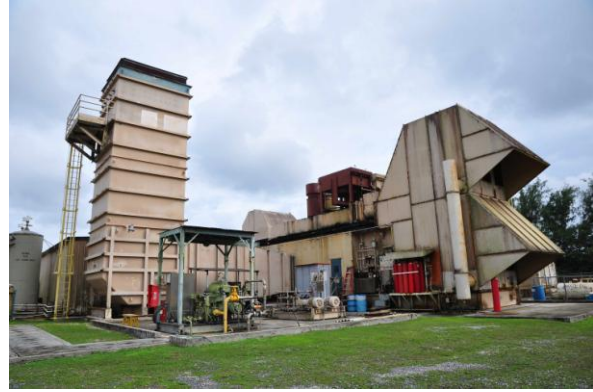
所有的輔機設備均是屋外式
