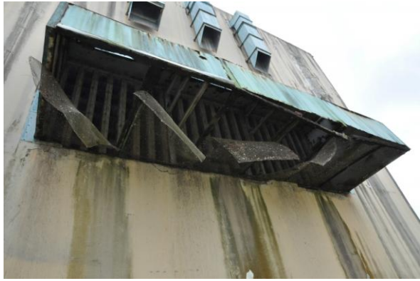
進氣室遮雨頂鋼板腐蝕破孔，需全部更新
