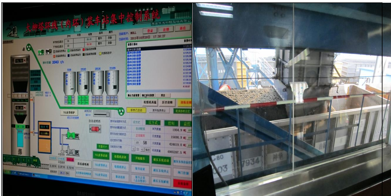
裝車線電腦控制螢幕(左圖)、裝車情形(右圖)
