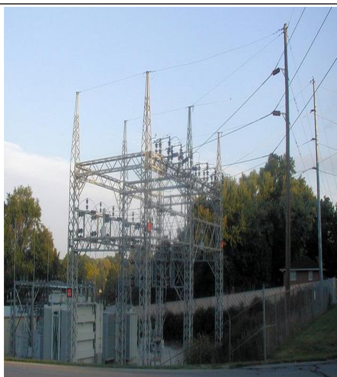
圖 2、69kV/13.8kV 變電所 (NPPD)
