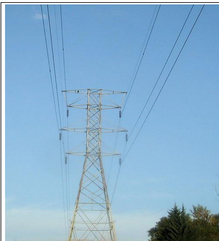
圖 1、69kV 輸電鐵塔 (NPPD)
