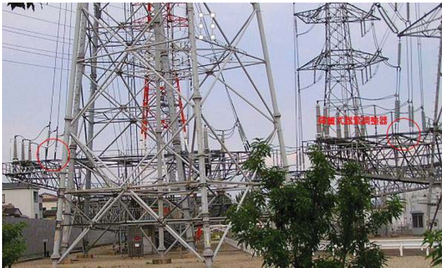
圖 17 信貴敷津線連接站鐵塔
