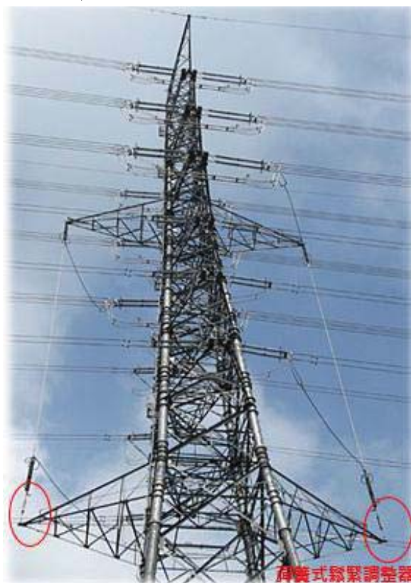
圖 21 换位塔引入裝置
