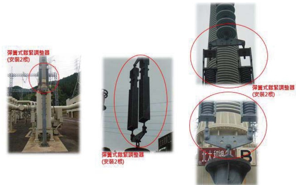
圖 23 變電站引入裝置
