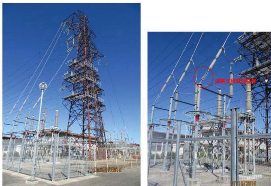
圖 15 北大阪小曾根線連接站鐵塔
