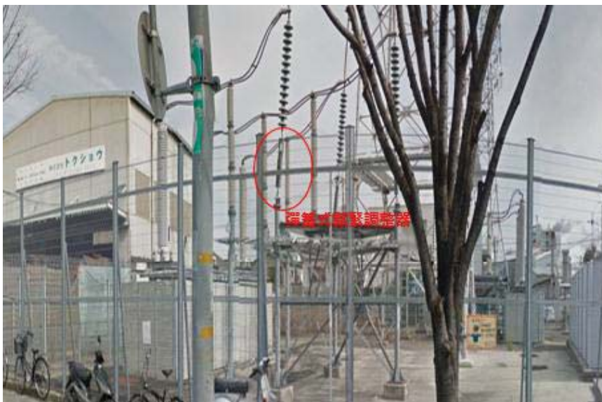
圖 18 御幣島線連接站鐵塔
