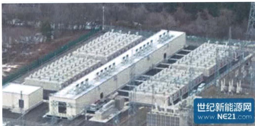
在西仙台變電站運轉的大型蓄電池系統 (攝影：東北電力)
