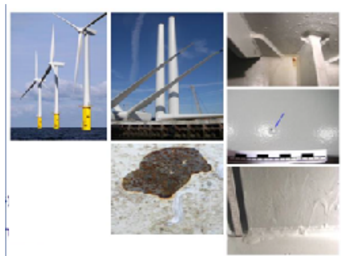
圖 4：塗料在防蝕保護方面塗膜劣化及維護不良
