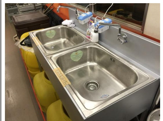
圖 32 啤酒專列上洗手台設備
