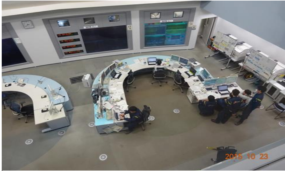
圖 4. J-POWER 磯子火力發電廠控制室
