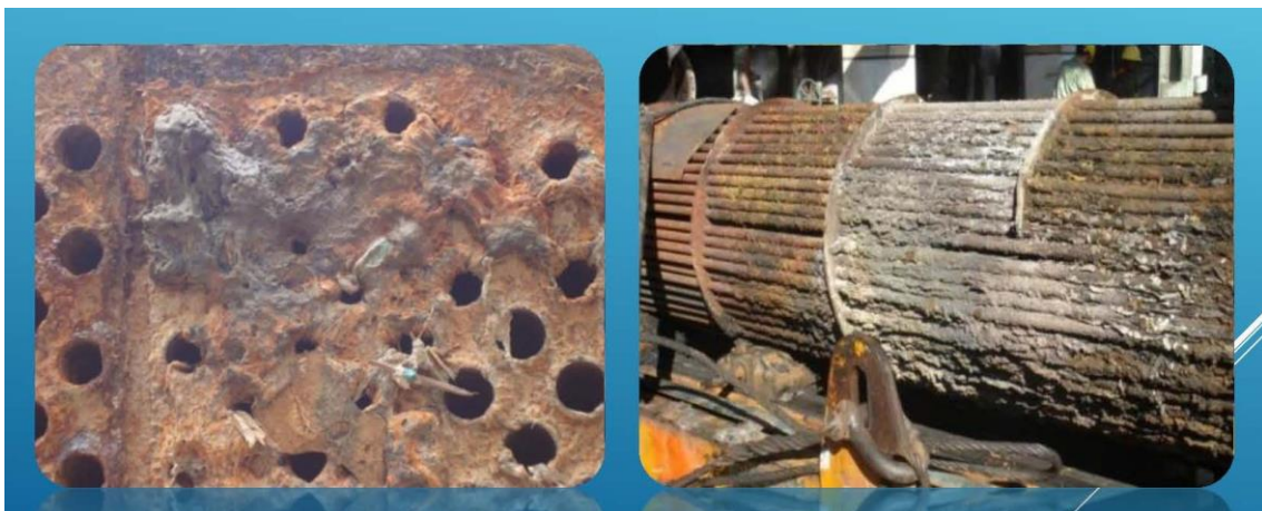
圖3.1 熱交換器表面腐蝕生鏽和附著污垢情形
