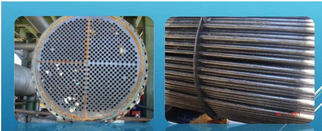
圖3.3 熱交換器表面使用TNP塗料3年後之情形
