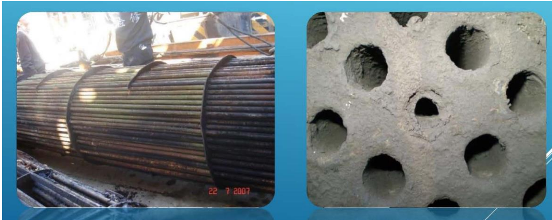
圖3.2 熱交換器表面使用環氧樹脂塗料3年後之情形
