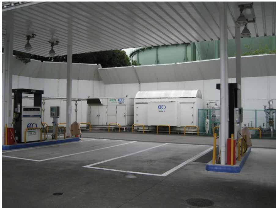
圖 10 天然氣加氣站設置設備
