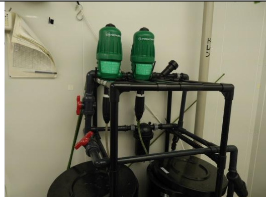
植物工廠內養液汲取系統(含稀釋器)
