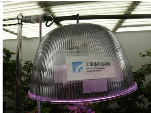
植物工廠控制室內搭配工業技術研究所研發的 LED 光源設備
