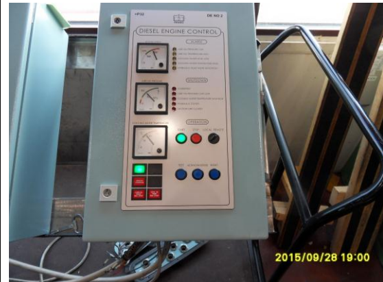
柴油引擎控制台
