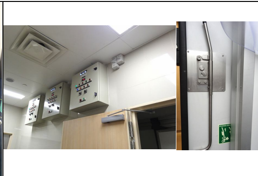
冷藏庫溫度控制由電腦連線/ 冷藏庫內安全逃生設施
