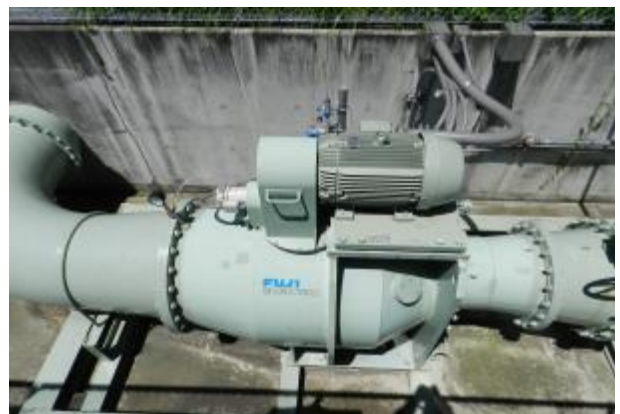
圖 34 現場小水力發電渦輪機設備
