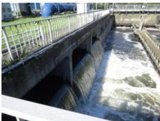
圖 41 森ヶ崎水再生中心設置小水力発電放流口
