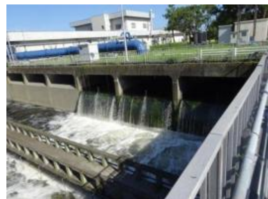
圖 42 森ヶ崎水再生中心設置小水力発電放流口
