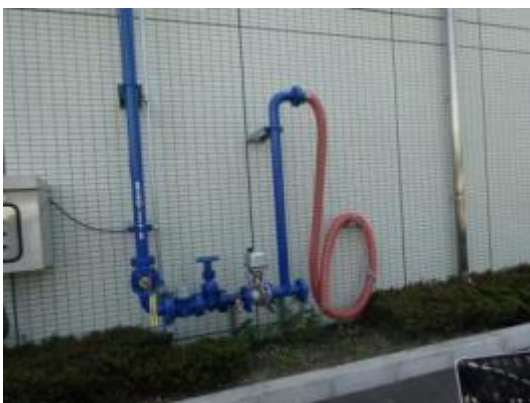
圖 7 芝浦再生水廠再生水供應洗街用水之取水口
