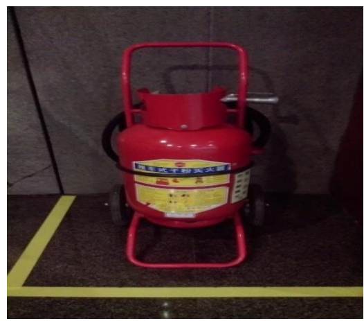
不同於臺史館，以推車式綜合乾粉滅火器作為主要滅火設備，方便於災害發生時能快速移動至起火點滅火
