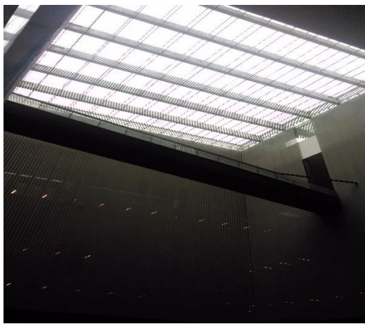
大廳 30 幾公尺挑高空間，完全直接利用太陽光作為大廳照明，兼具省電、避免挑高區域燈具更換難度高及節省維護費用
