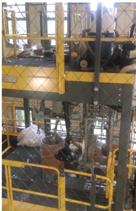
圖：羅格斯大學連續製藥先進製造實驗室-小型製藥工廠之製藥塔台
