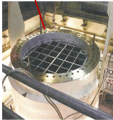
垂直存放乾式貯存設備
