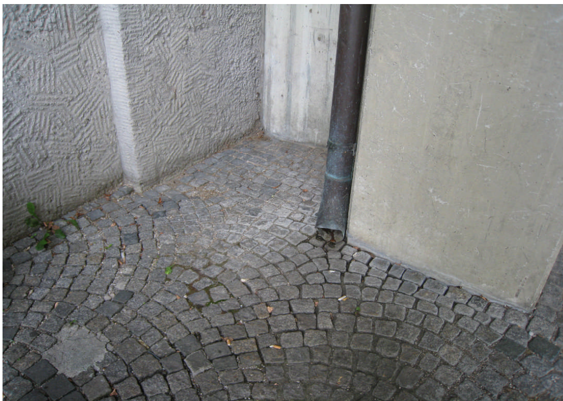
圖二十二 部份排水館排放水於地表面
