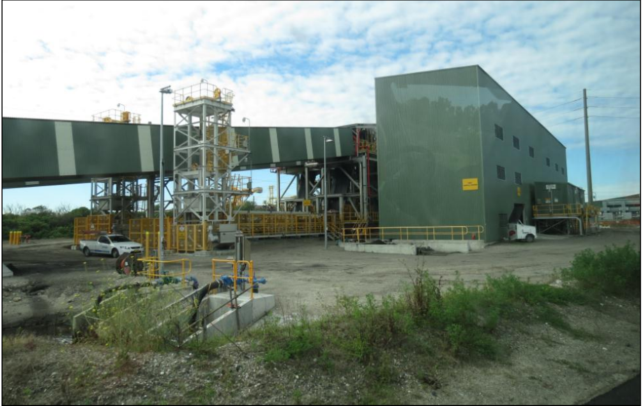
圖166 NCIG 火車卸煤後之取樣站
