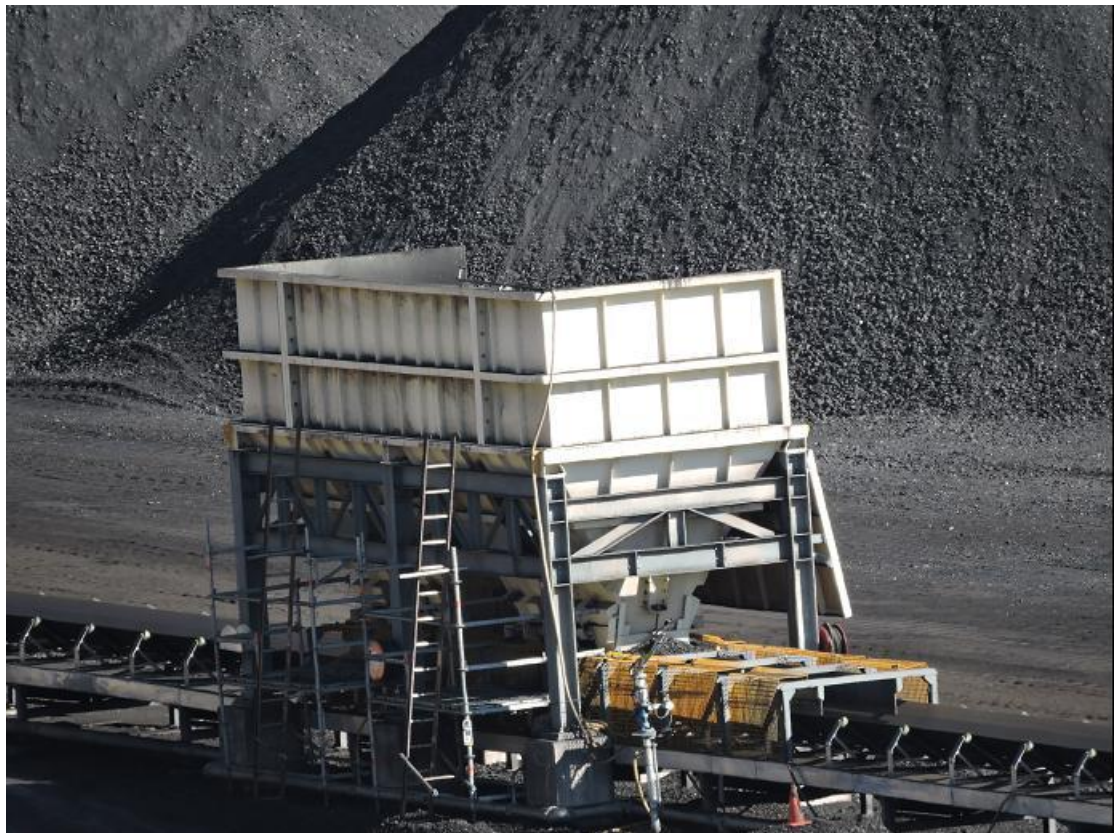
圖133 Maules Creek 礦區臨時取煤設備
