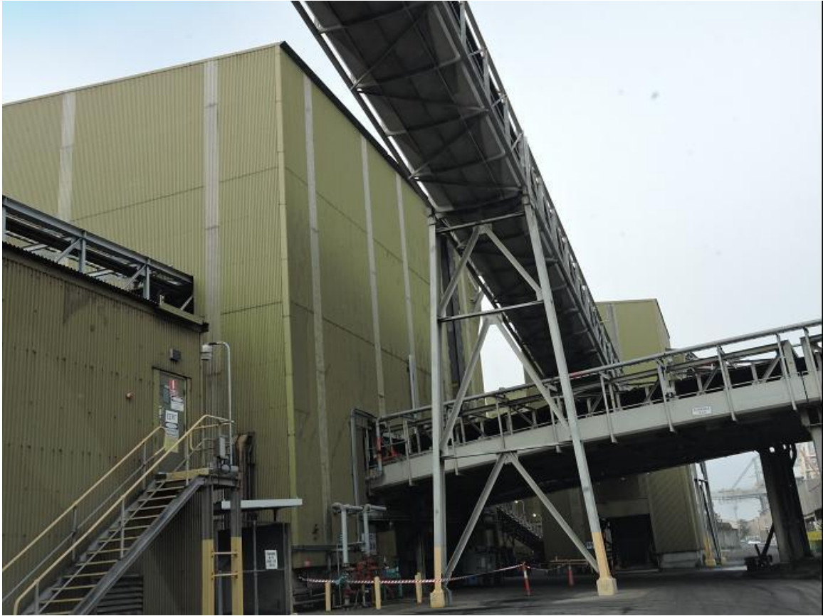
圖146 PWCS 火車卸煤站取樣站
