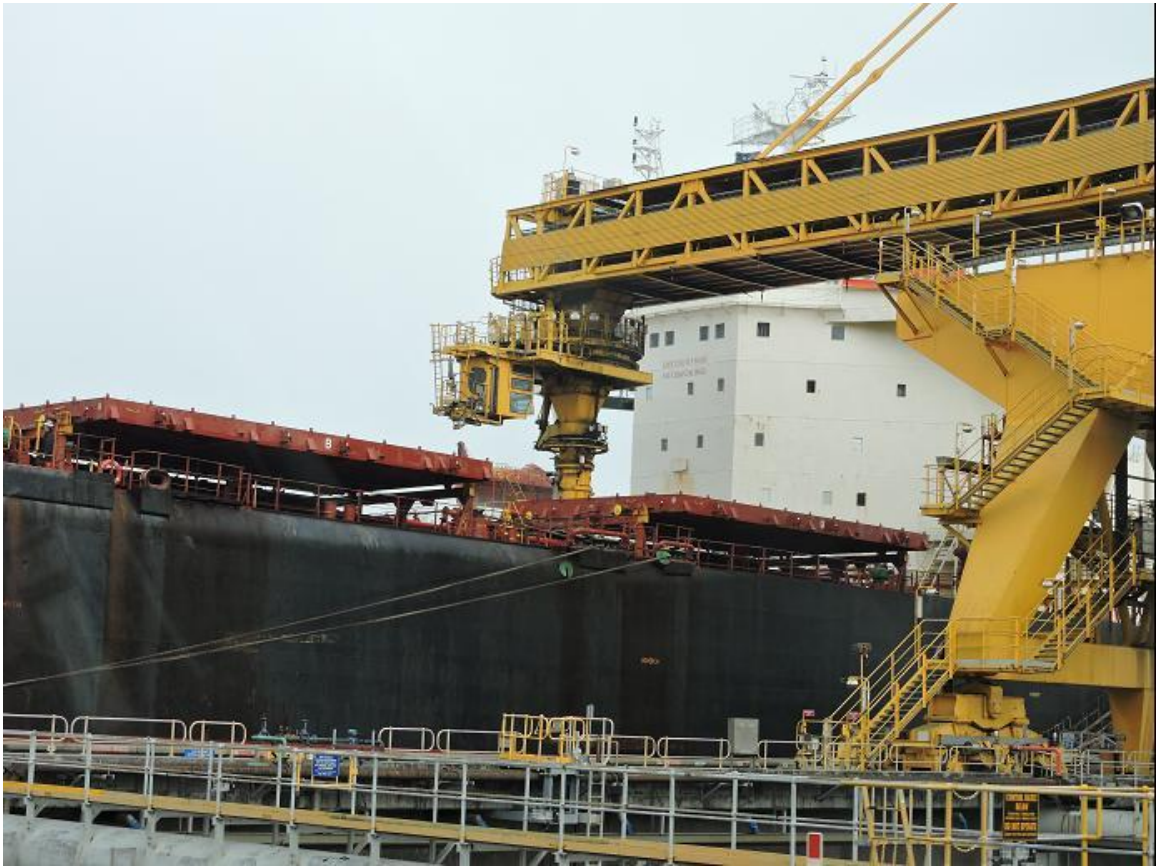
圖156 PWCS Shiploader 裝煤作業
