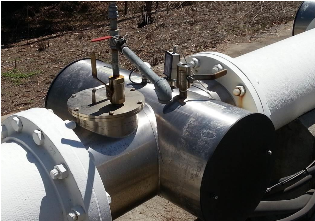
圖 36 ASR 試驗站原水殺菌設備
