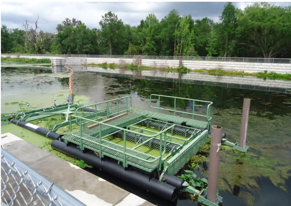
圖 13 人工濕地進流口設置之沉砂池及垃圾清除設施
