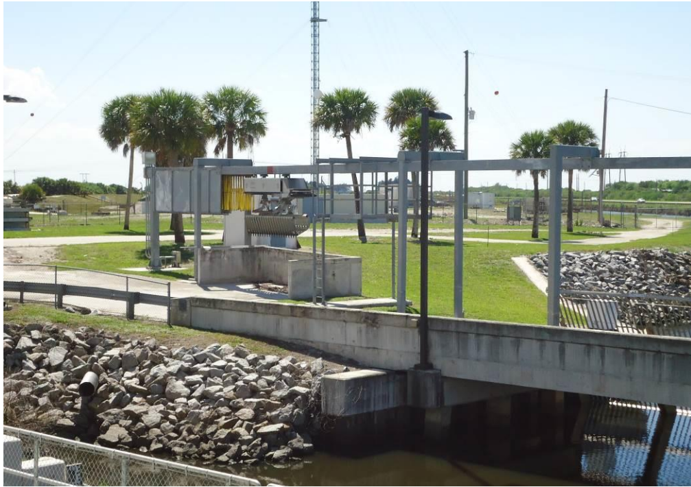
圖 41 S-5A 抽水站攔汙閘與自動清汙設備
