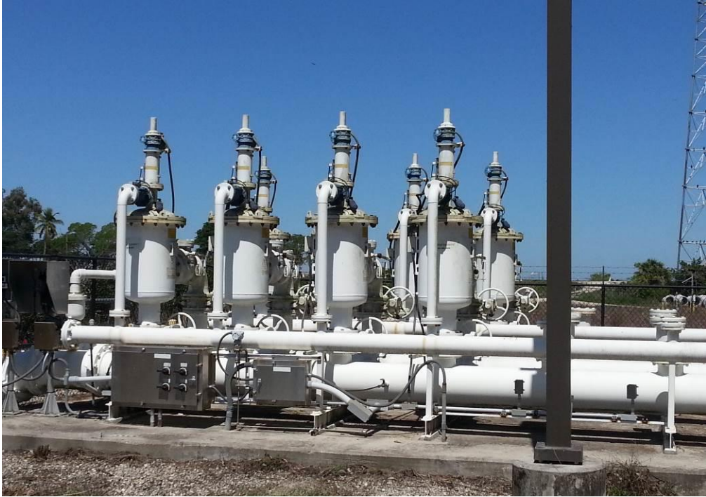
圖 35 ASR 試驗站原水過濾設備
