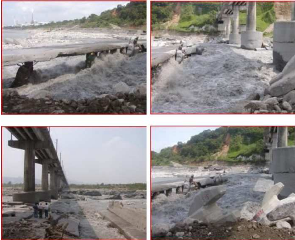
圖 3.7 颱風過後大甲溪橋橋墩及攔水堰沖刷現況
