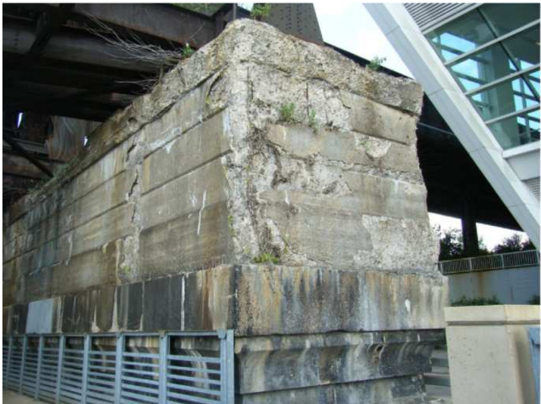
圖 5.24 鋼橋橋墩抵不住歲月催化的痕跡
