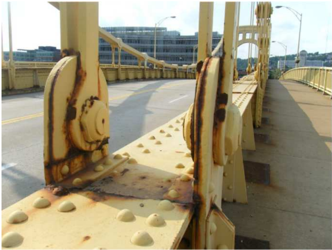
圖 5.28 橋梁鏽蝕狀況
