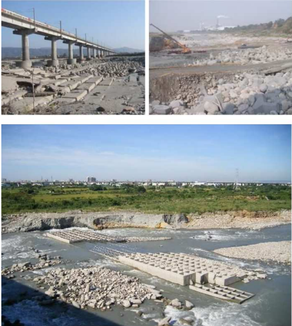
圖 3.8 大甲溪橋下游攔水堰破壞情形
