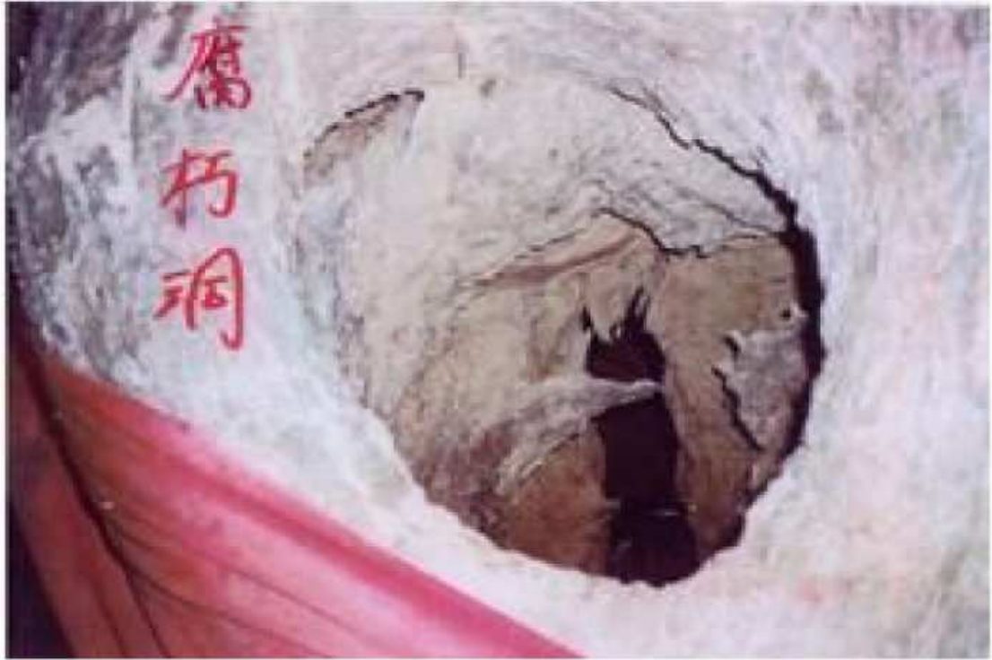
圖 3.30 遭白蟻侵蝕所致的腐朽洞
