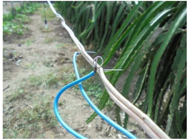
夜間電照線路設置十分簡單，在電線兩側直接以鐵釘插入通電，但有漏電危險
