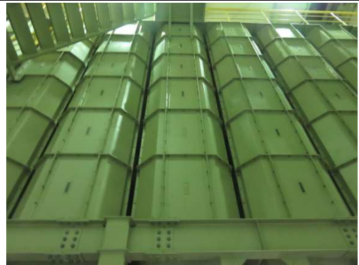
糙米的立式貯存槽
