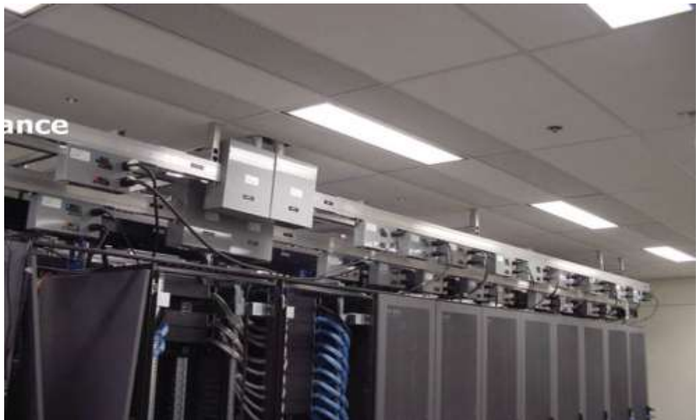
電腦機房以匯流式配電槽(BUS WAY)布線
