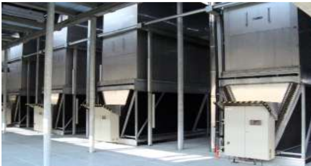
密閉式冷卻水塔
