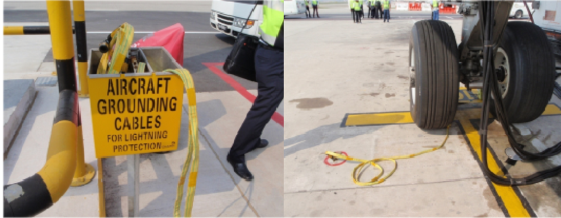
圖 12：航機接地設備
