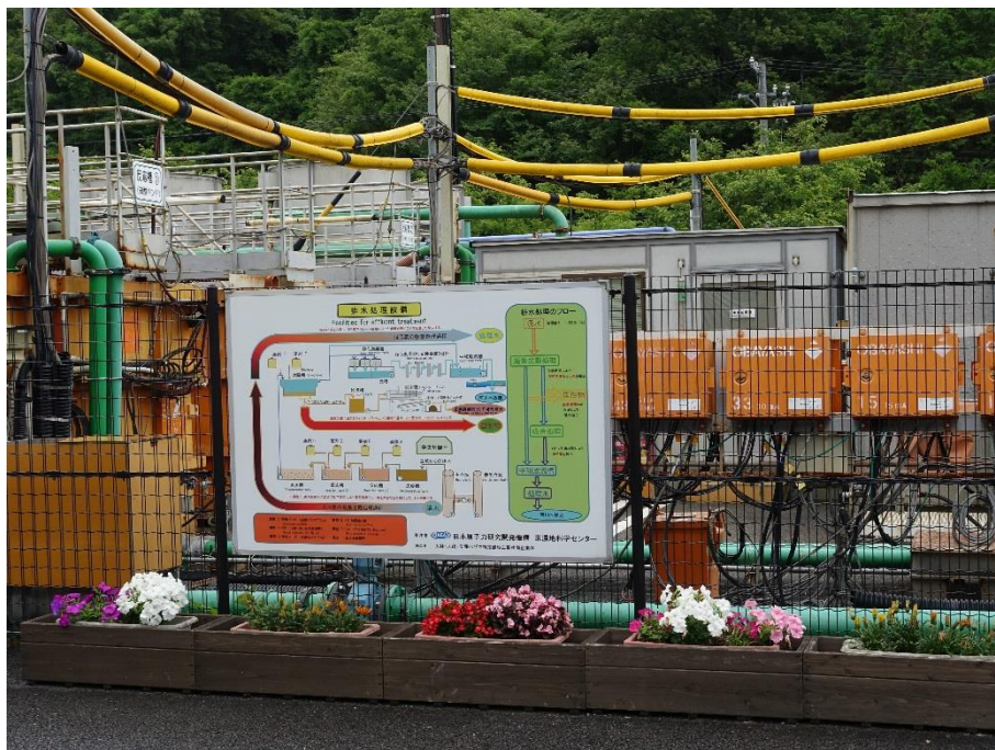
圖 35：瑞浪地下實驗室排水處理設備
