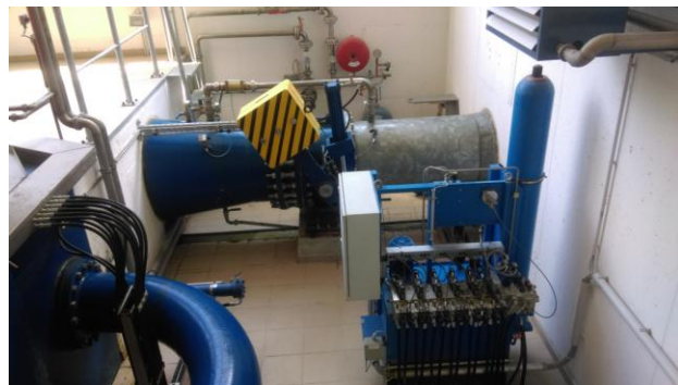
Photo.10 Sunkbach 廠房端壓力鋼管
