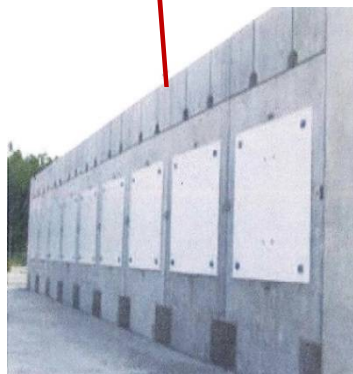
水平存放乾式儲存設備
