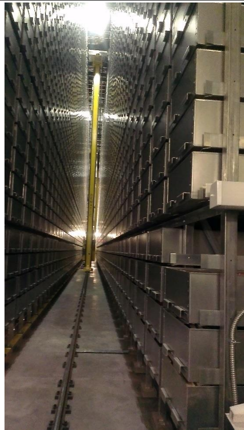
自動儲存與檢索系統機器手臂軌道
