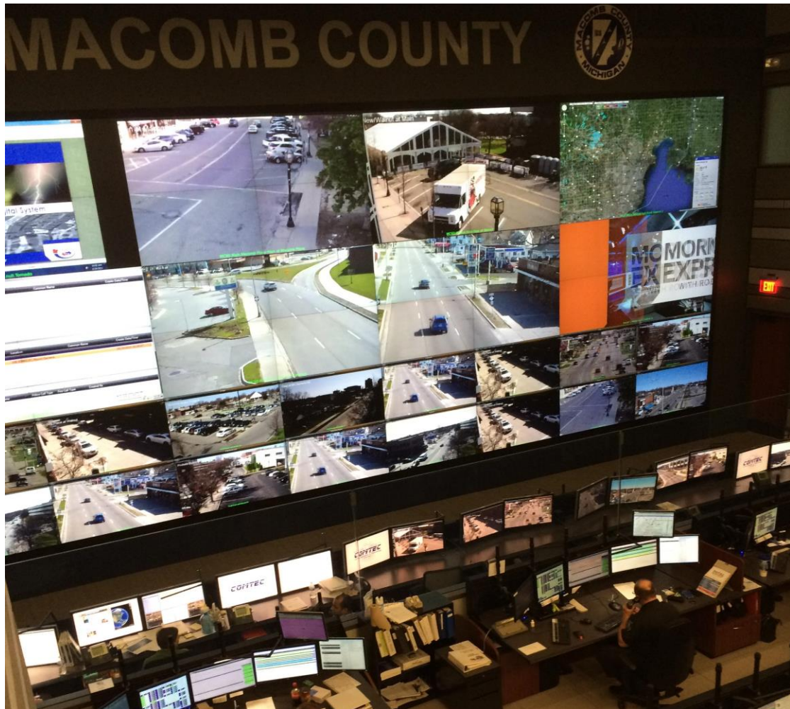
圖9 Macomb COMTEC監控電視牆
