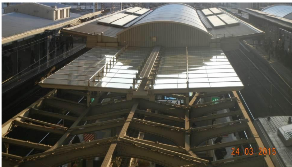
圖 3-14：月台雨棚上方設有太陽能光電板
