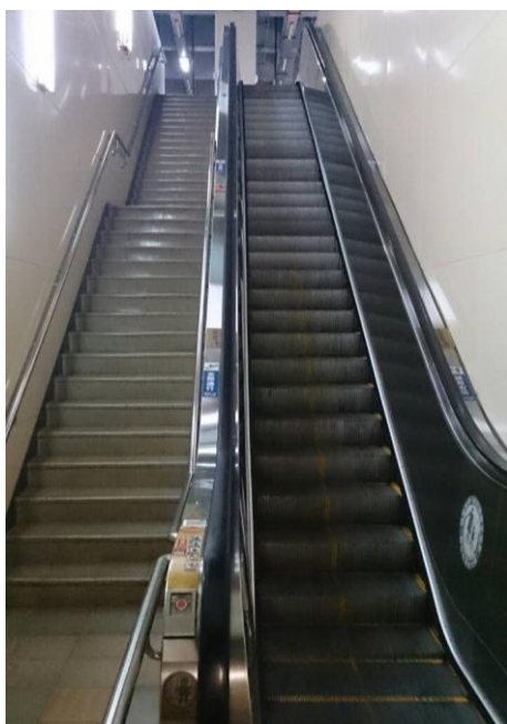
圖4-5：本局車站受限月台寬度不足僅設單向電扶梯造成旅客不便
