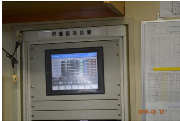
照片 3.33 雨量監測裝置
