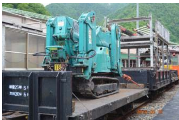
照片 3.13 台車上工程維修用機械
