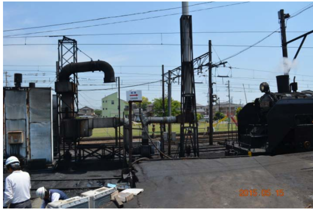
照片 6.37 機車熱機時排氣汙染處理設備
