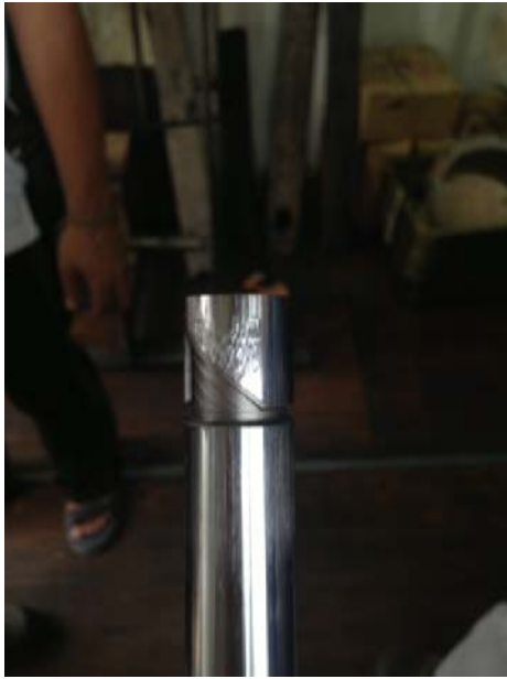
圖 13. 柱塞磨損情形。
