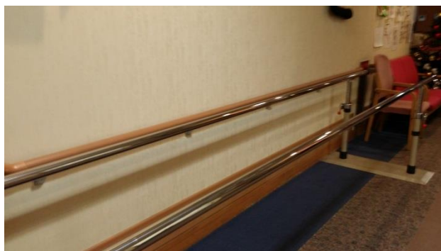
每層樓入口處設置復健輔具
