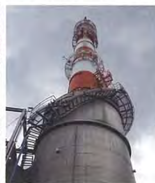
脱硫除塵装置
