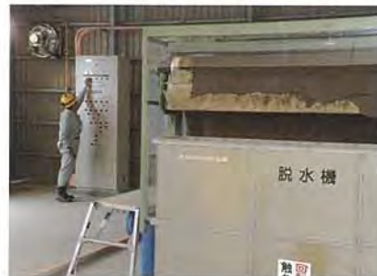
溜まった汚泥は脱水して 鉱石に混ぜて全量再利用
