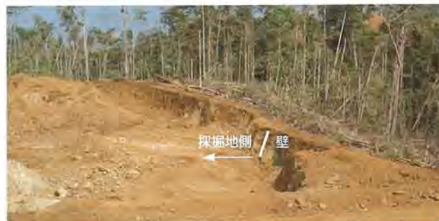
採掘地の外縁に高さ2-3mの壁を作ることにより、採掘時の土砂が採掘地外に流出しないよう工夫
