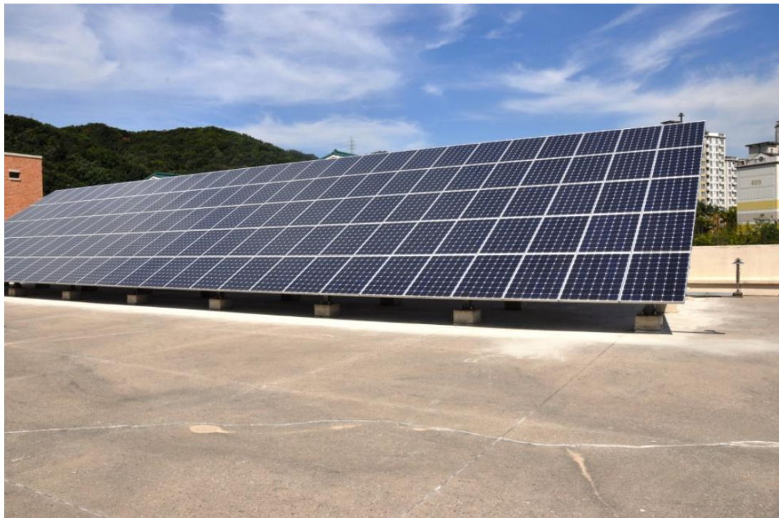
首爾南部監獄之太陽能發電板
