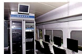
▲ 信號檢測系統 Signal Inspection System
