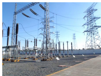
220kV 屋外型開關場
