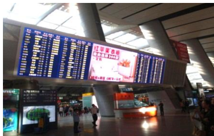
候車大廳 PIS 大型 LED 看板
