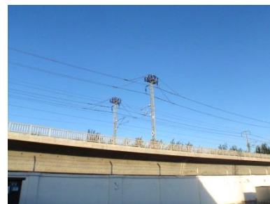
電車線隔離開關
