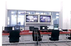
▲ 试验控制系统 Testing Control System
