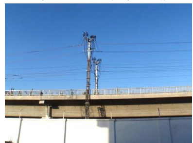
變電站 27.5kV 饋線接至電車線
