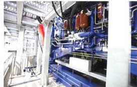
▲ 試驗台潤滑控制系統 Lubrication Control System
