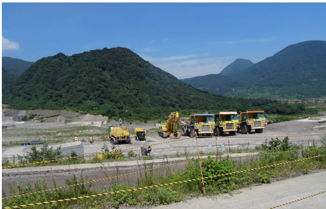
圖 78 各類大型機具由控制中心操控。
