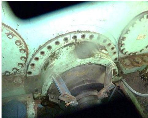
#4 軸承下半進油孔被異物堵塞
