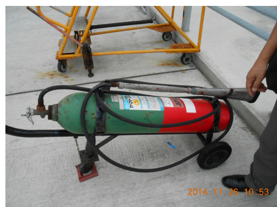
【機坪消防設備】
