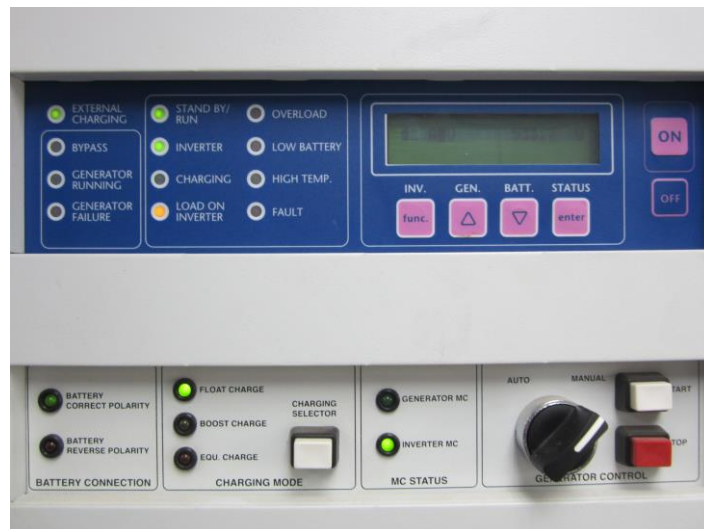
圖三十三、儲能系統之交直流電力轉換器機台之功能控制面板
