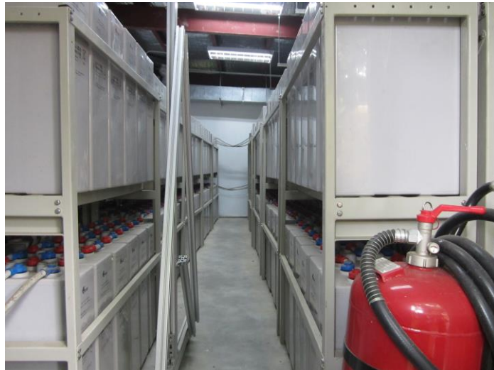
圖二十八、屋敏島微電網試驗場 1MWh 容量之鉛酸電池組
