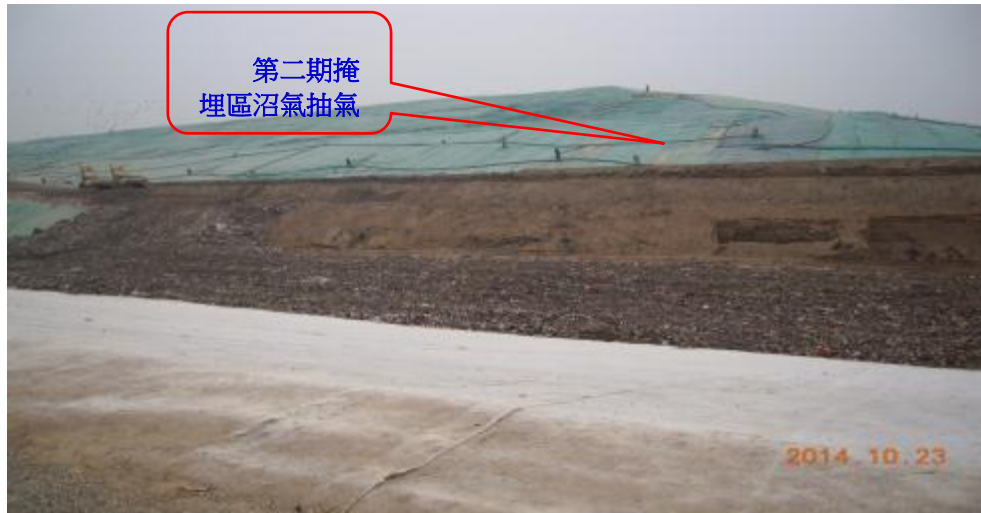
圖 3.2-30 安定衛生掩埋場第二期掩埋區沼氣抽氣設備
