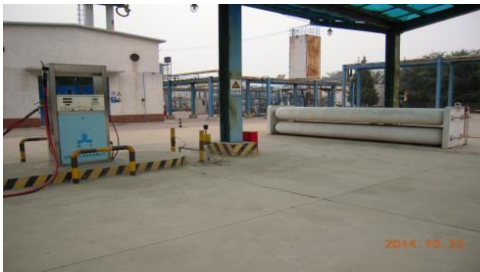
圖 3.2-32 安定衛生掩埋場天然氣加氣站
