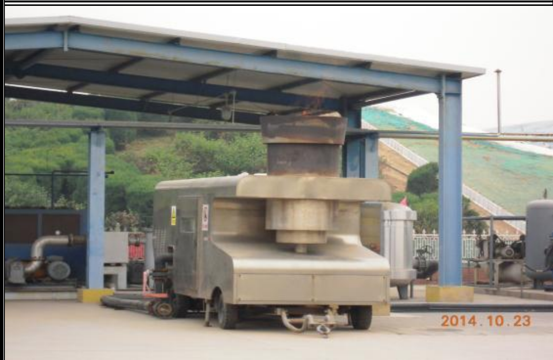
安定衛生掩埋場移動式沼氣燃燒車
