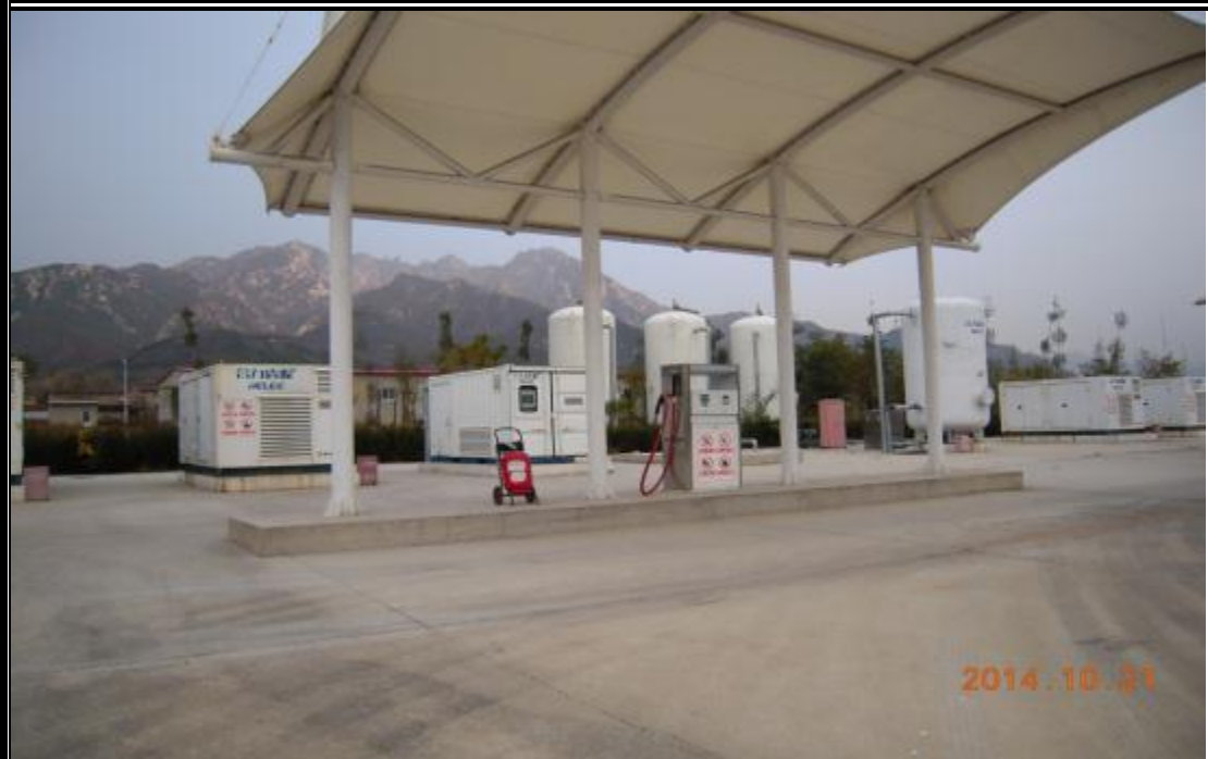
德青源生態園天然氣提純壓縮加氣站
