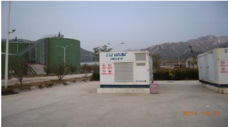
圖 3.2-15 廠內移動式沼氣壓縮設備
