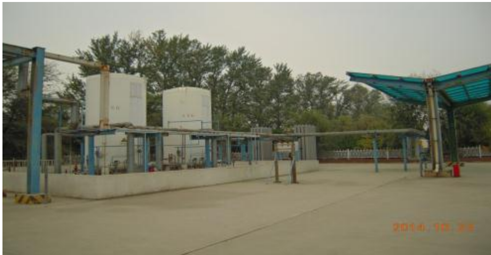
圖 3.2-31 安定衛生掩埋場天然氣貯槽
