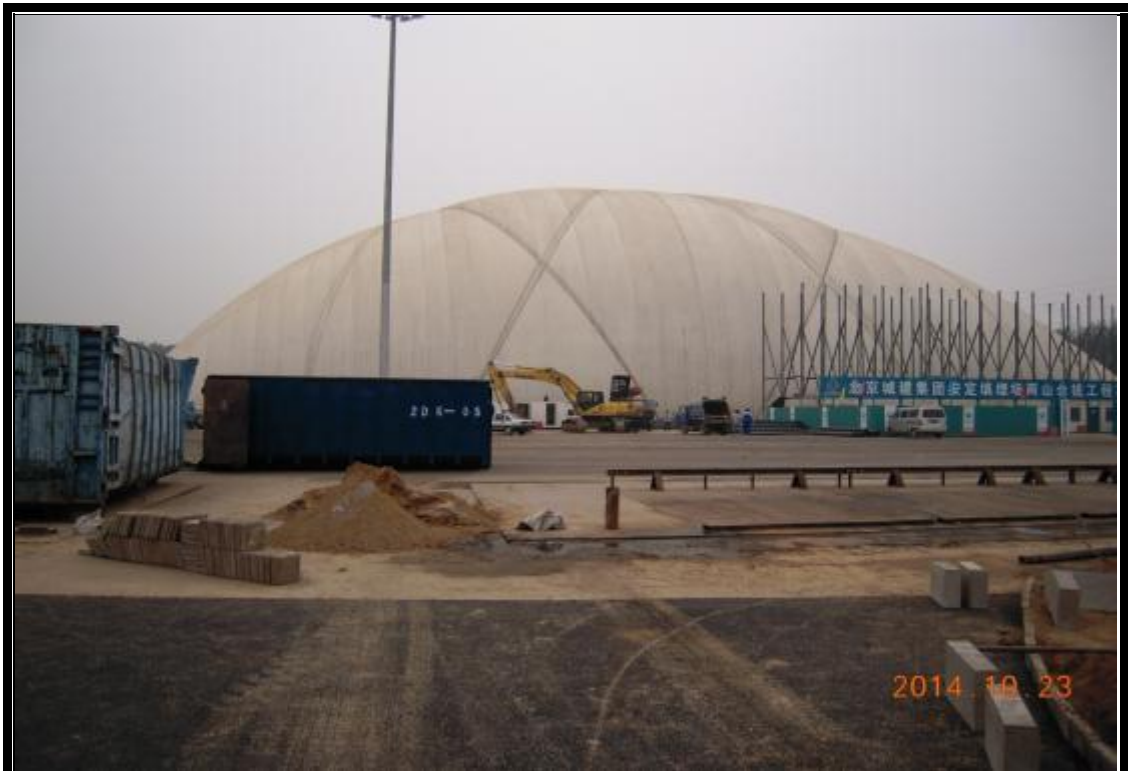
安定衛生掩埋場密閉移動式垃圾掩埋大棚
