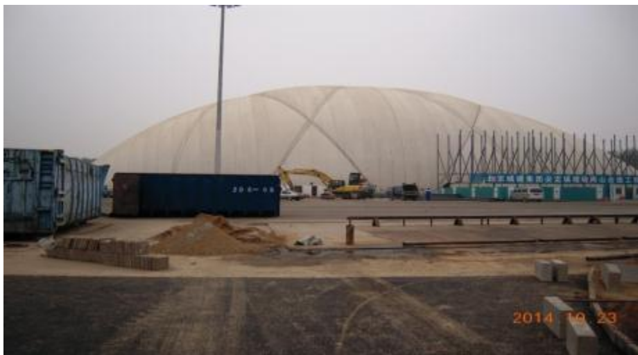
圖 3.2-25 安定衛生掩埋場密閉可移動式垃圾掩埋大棚
