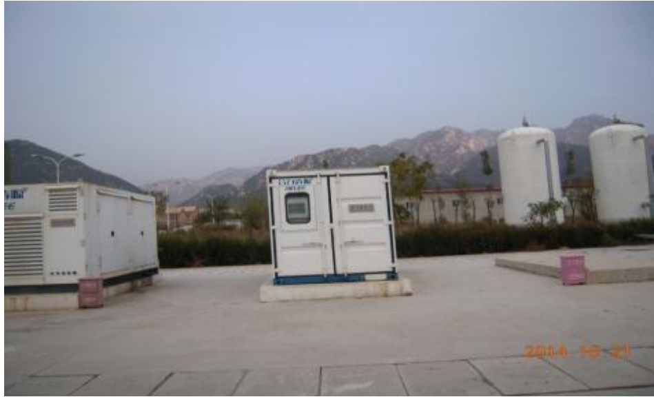
圖 3.2-14 廠內移動式沼氣提純設備
