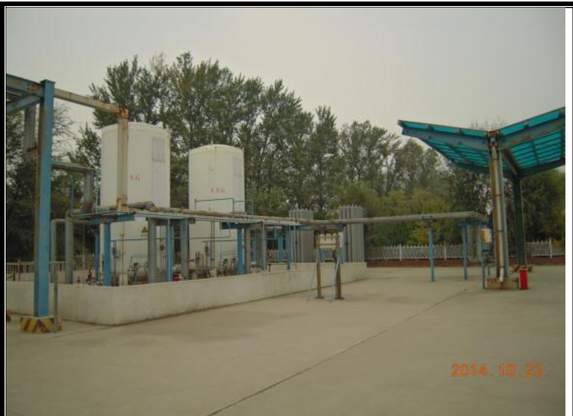
安定衛生掩埋場天然氣設備
