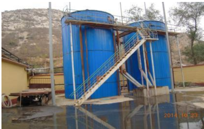
圖 3.2-22 東華山沼氣服務站發酵槽
