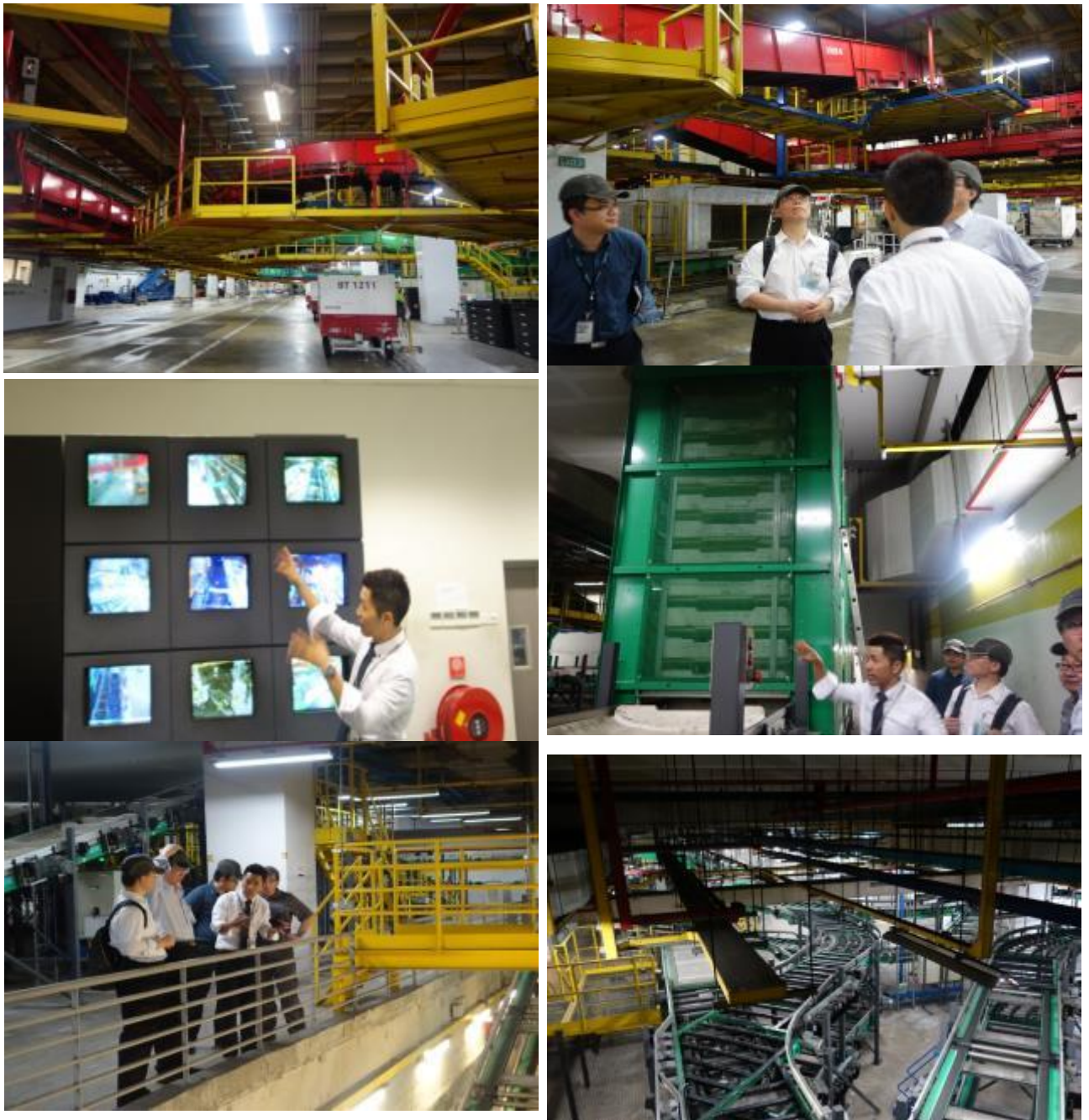
圖 3-12 樟宜機場行李分檢系統(BHS)實際參觀
